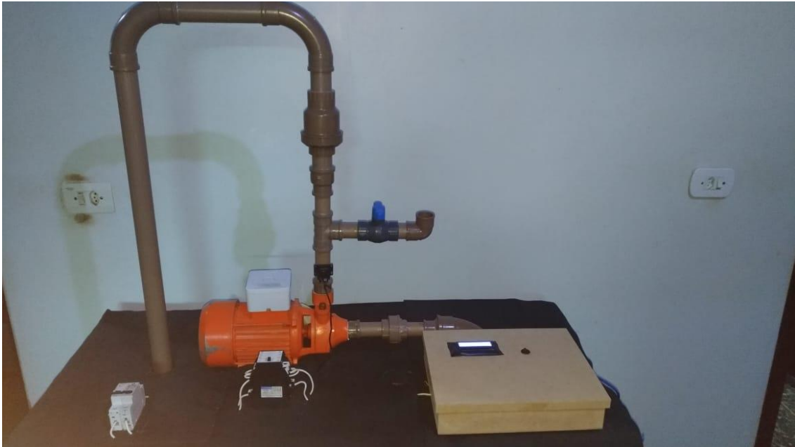
Figura 25 - Sistema de segurança para verificação de escorva do conjunto motobomba.
