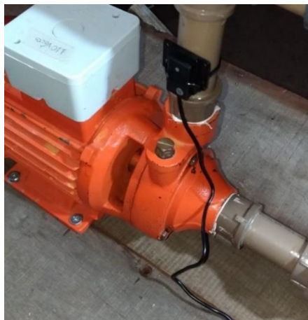
Figura 12 - Local de instalação do sensor.
